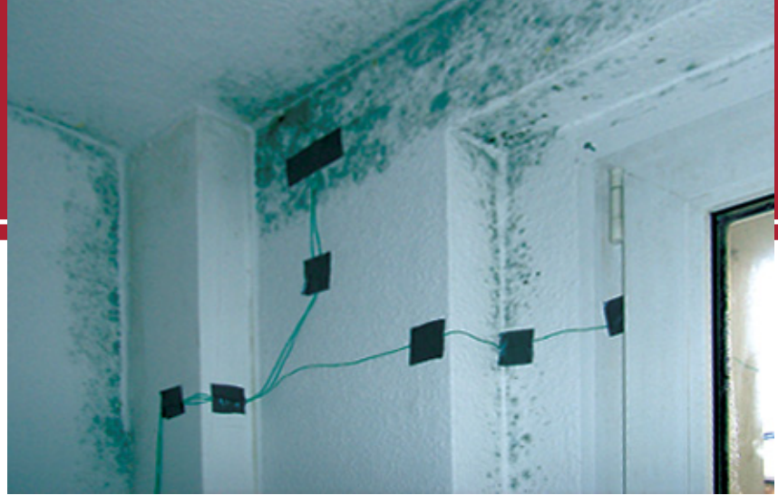
Ein typisches Schimmelbild bei einer Untersuchung durch Gutachter.
