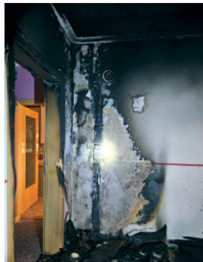
Brandstelle und Brandherd.
