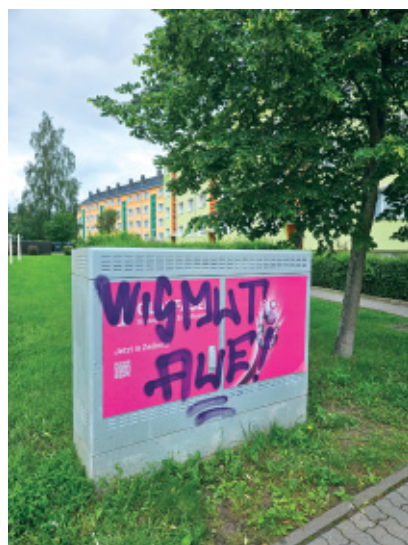
Eben erneuert von der Telekom und schon wieder beschmiert.
