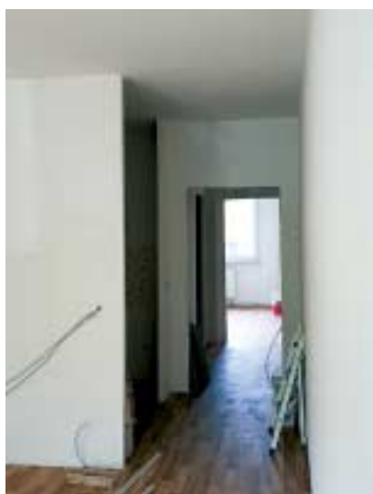
Eine Wohnung in der Sanierung. Mangels Handwerker dauerts oft Monate und führt zu Leerstand.
