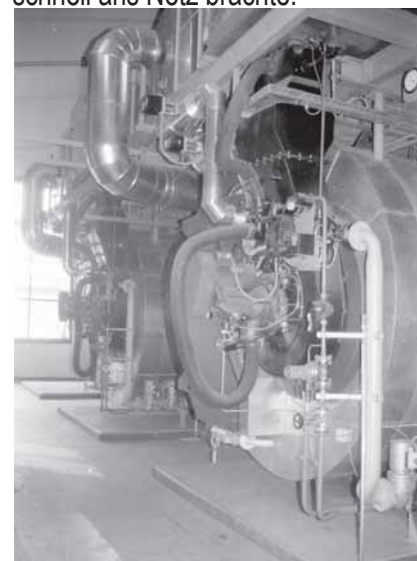
Nicht wenig technischer Aufwand für die Heizung.
