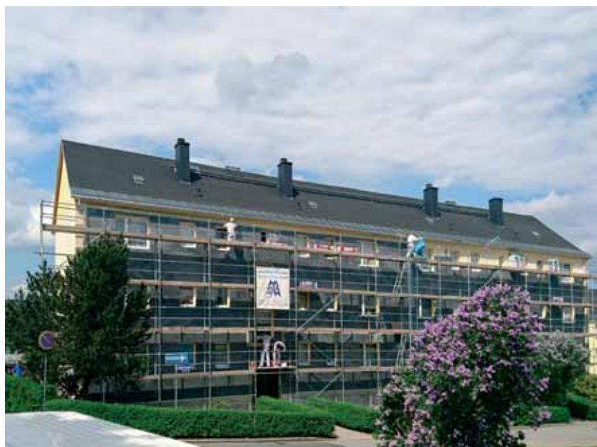
Die Fa. Werner bringt im Mai am Haus Breite Str. 10/12 das Wärmedämmverbundsystem auf. Auch wenn das sehr aufwendig ist, bringt es den Mietern auf alle Fälle Ersparnisse beim Heizen.
