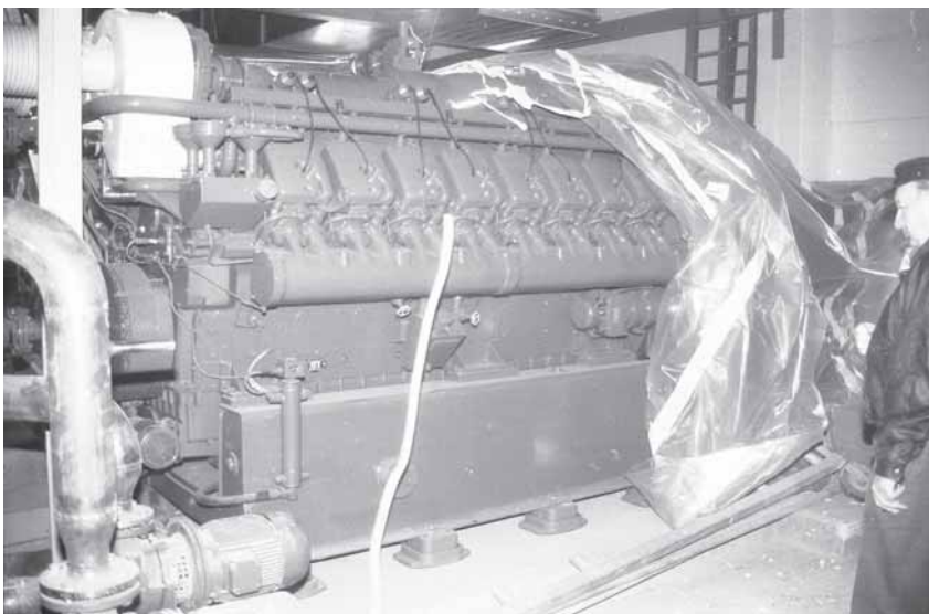
Artur Dietze vor einem der neuen Generatoren zur Stromerzeugung. Mit der Abwärme wird nun geheizt!
